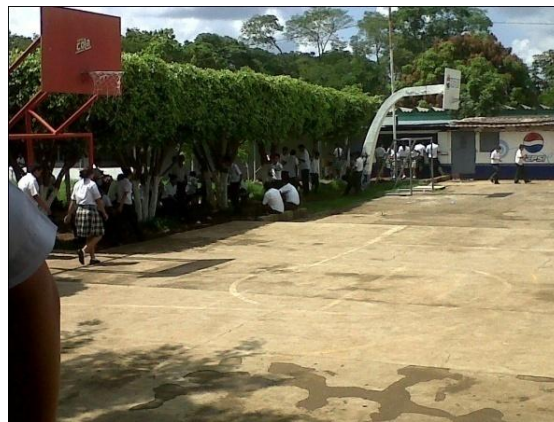
Canchas de básquet ball del instituto en mal estado.
