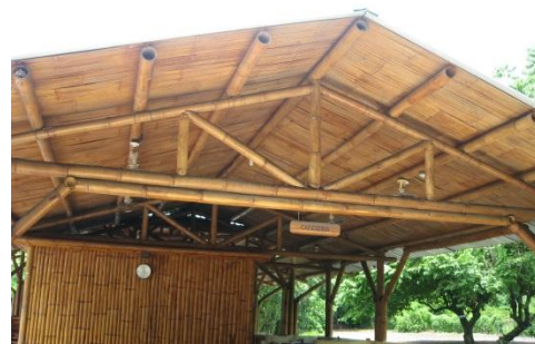
Descripción: Tijera estructural. Fotografía: Aníbal Rodríguez, 11 de septiembre 2013.
