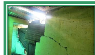
FOTO 28 VIVIENDA AFECTADA POR SISMO 7/11/13, LA LOMA SECTOR 2, SAN MARTIN SACATEPEQUEZ FUENTE: ALONDRA GUZMAN FECHA: 11/7/2014
