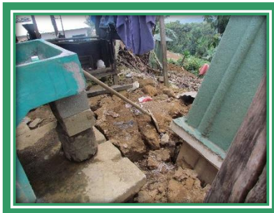
FOTO 29 DESLAVE VIVIENDA AFECTADA POR SISMO 7/7/14. LA LOMA SECTOR 2. SAN MARTIN SACATEPEQUEZ FUENTE: ALONDRA GUZMAN FECHA: 11/7/2014
