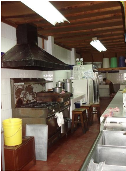
Ilustración 27 Cocina semi-industrial; fuente: propia junio 2012
