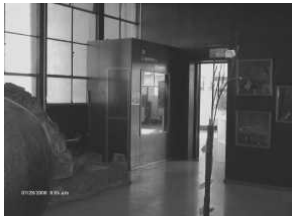
Sala de exposición en la fotografía se puede apreciar los ventanales del salón los que dañan las colecciones por la luz solar y además incrementa el riesgo por vandalismo pues sería fácil irrumpir.
