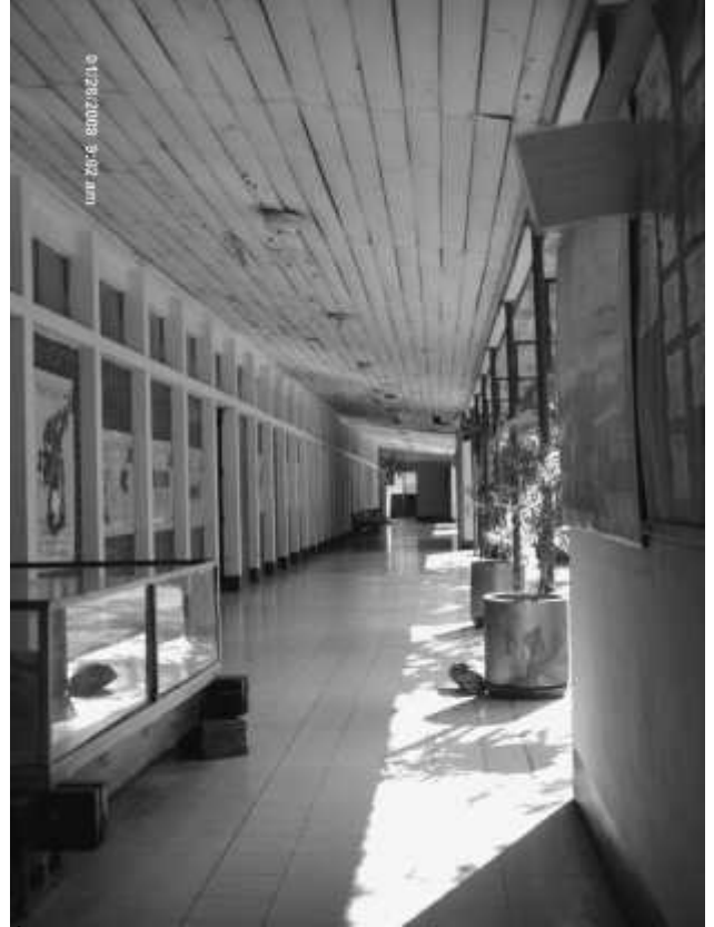
Área de pasillos de las exposiciones actualmente, y por esto se interrumpe el recorrido pues al salir de un salón a otro se pierde la atención o salen a otros salones y no continúan el recorrido como esta proyectado. También se puede apreciar el daño y el mal estado del machimbre.
