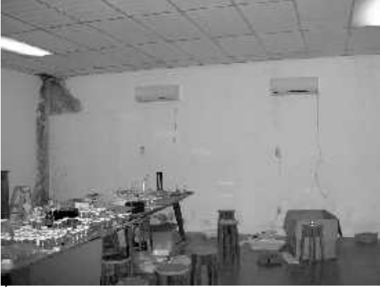
Área actual de trabajo húmedo, se puede apreciar la humedad en las paredes y el cielo falso en donde se crean microbios que dañan las colecciones.
