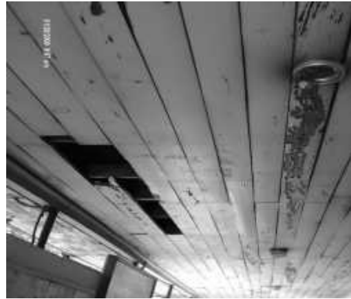
Mal estado del machimbre en pasillos.
