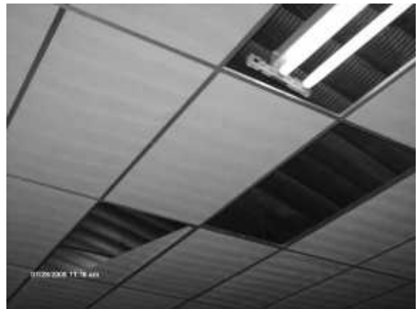
Mal estado del cielo falso en el área techada con EMCO
