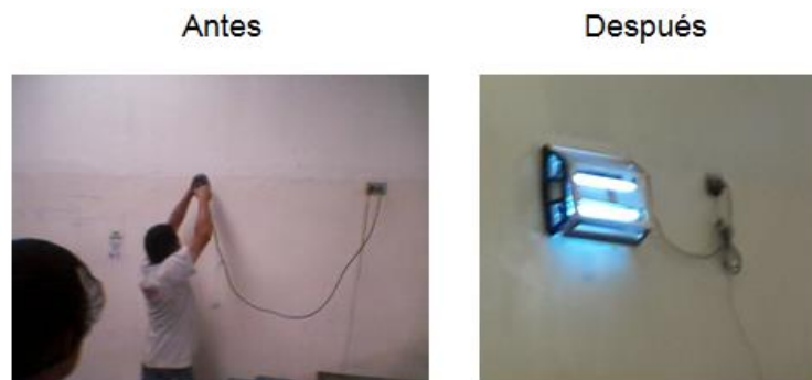
Figura 46. Colocación de lámparas ultravioleta
