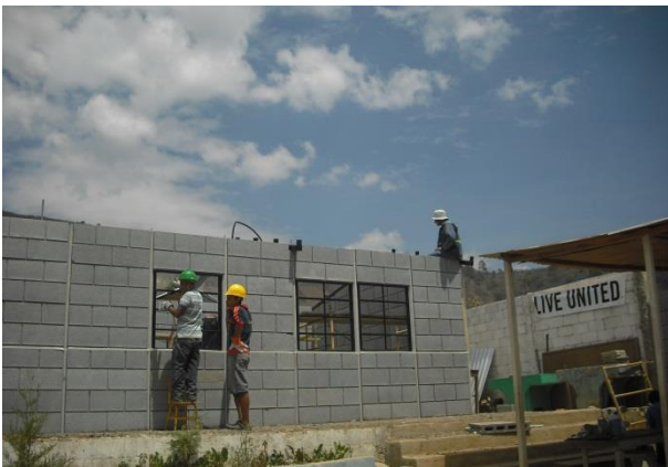
Fotografía 34, Imágenes donde se observa la construcción de las 2 aulas, donadas por una asociación de Empresarios.
