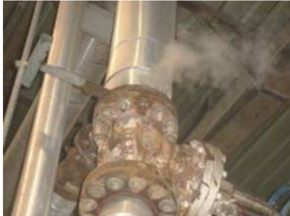
Figura 49. Fuga de vapor en tubería
