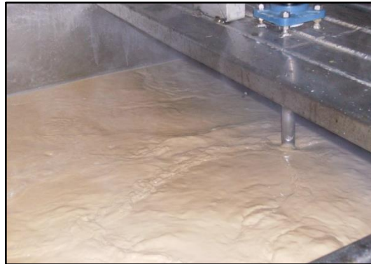
Figura 14. Tanque de elevación de temperatura de producto
