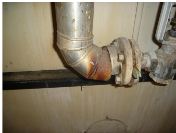
Figura 50. Enchaquetado de tuberías en mal estado
