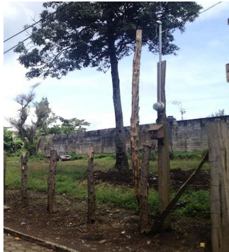
Imagen 37. Acometida eléctrica en el terreno. Fuente: José Somoza. Año: 2013
