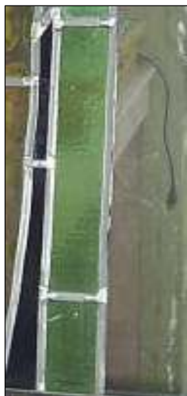
Fotografía 2. Panel 2 del vitral PAX, deformación de riel exterior del bastidor, detalle.
