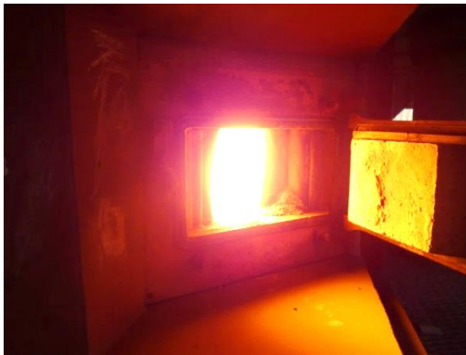
Figura 9. Ventana de inspección de quemadores
