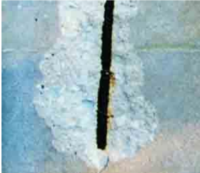
Figura 15. Efecto de carbonatación en el concreto armado
