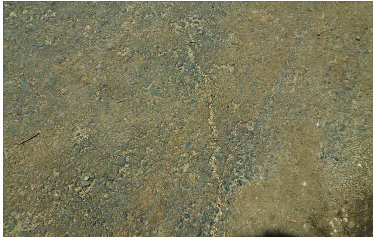
Figura 53. Grieta de borde localizado en el perímetro universitario
