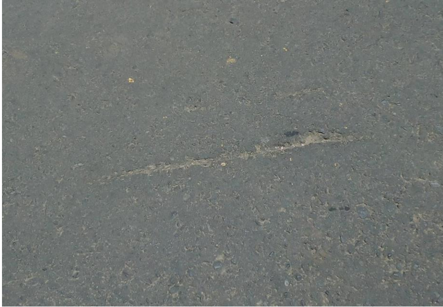
Figura 54. Grieta longitudinal en el perímetro universitario
