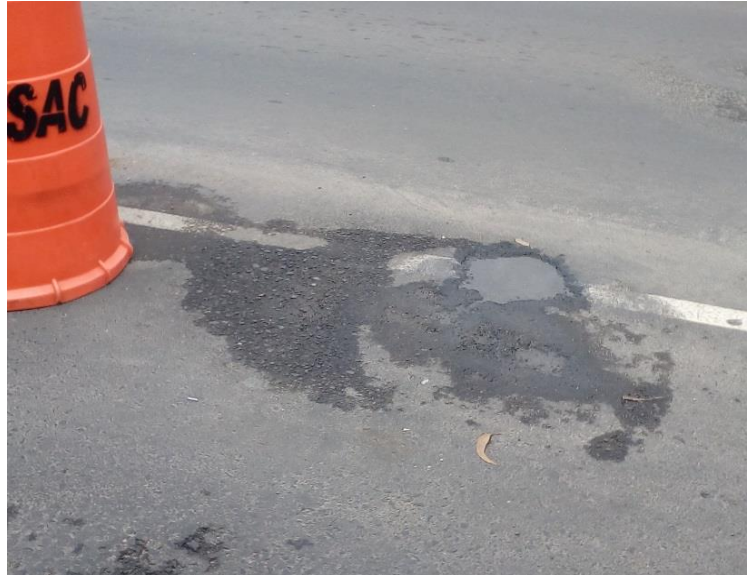
Figura 52. Bache localizado en el pavimento universitario
