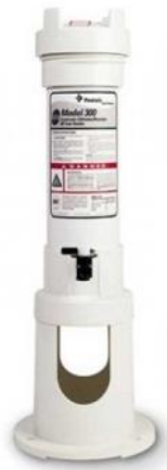
Clorador fuera de línea
