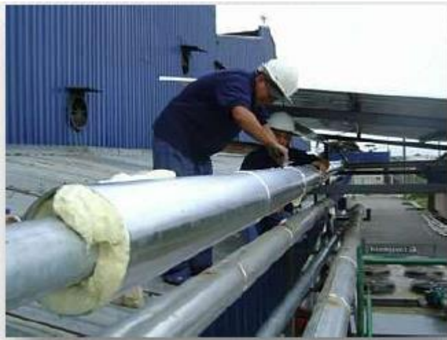
Figura 16. Tubería con aislamiento térmico
