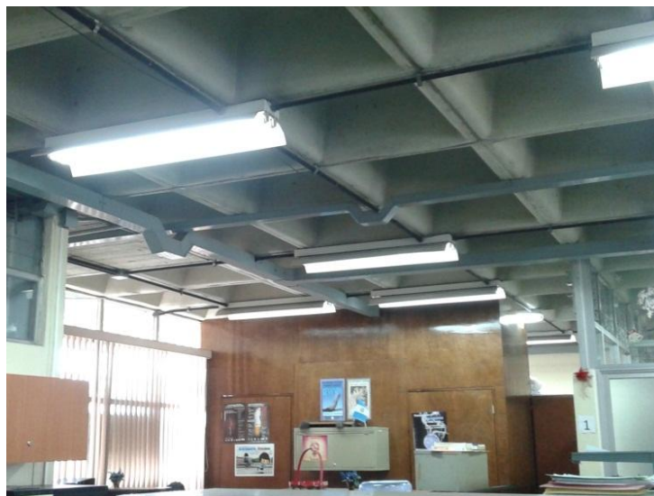
Figura 20. Luminarias en el área de recepción
