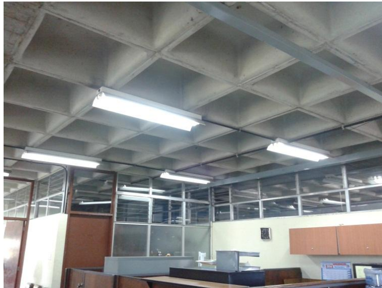
Figura 19. Luminarias en el área de secretarías
