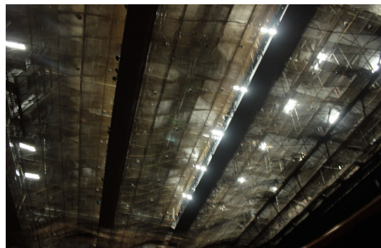
Imagen 12. Vista de tratamiento Acústico en la gran sala, toma propia 2015.
