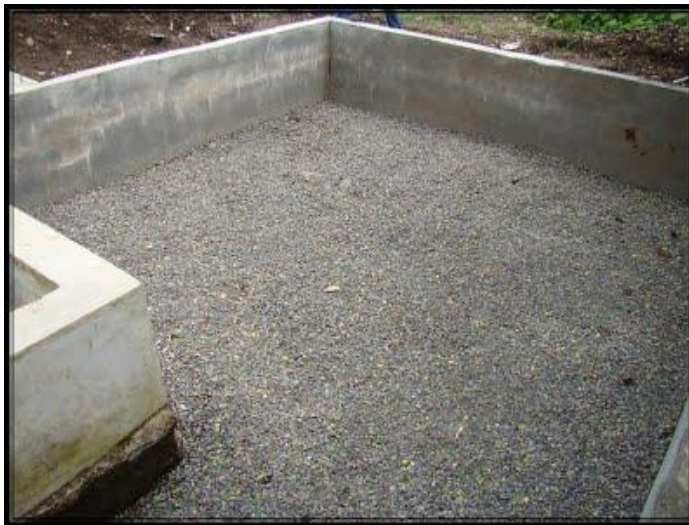
Figura 14. Patio de secado de lodos
