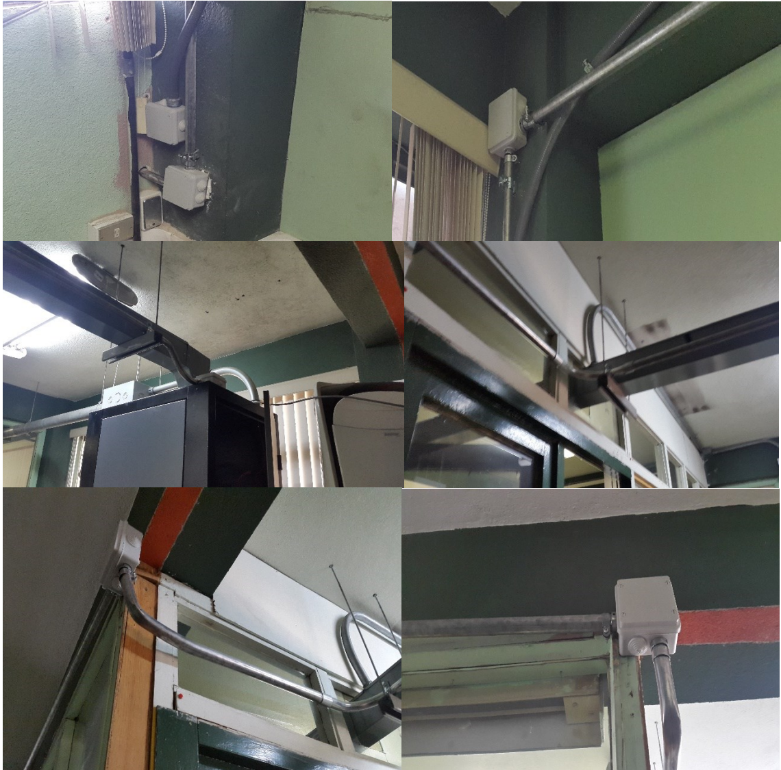
Figura 8. Tubería que conduce de Centro de Cálculo e Investigación Educativa hacia la sala de proyecciones
