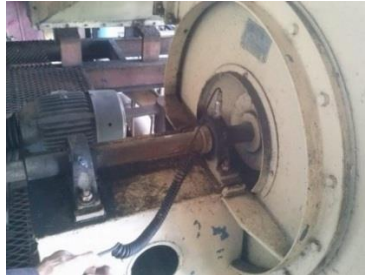
Figura 30. Ventilador inducido de horno punto 4V
