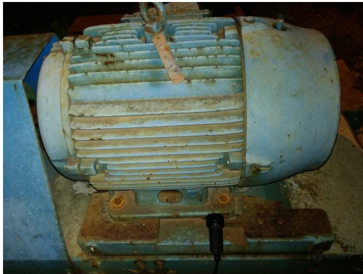
Figura 7. Colocación incorrecta del sensor, lejos del soporte del rodamiento
