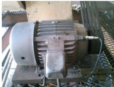
Figura 25. Ventilador inducido de horno punto 2ª
