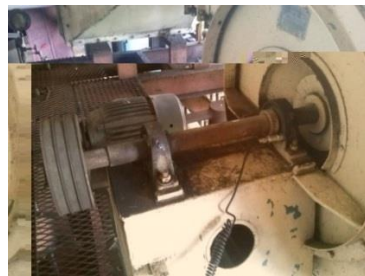
Figura 31. Ventilador inducido de horno punto 4 a
