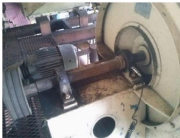
Figura 29. Ventilador inducido de horno punto 4H
