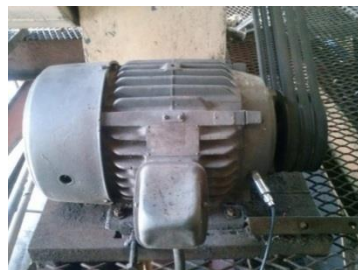
Figura 23. Ventilador inducido de horno punto 2H
