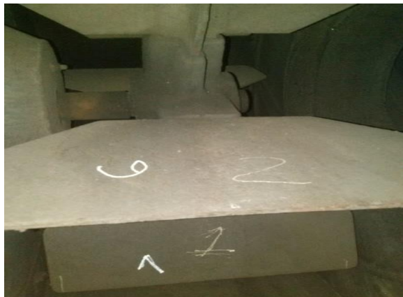
Figura 32. Aspas de ventilador inducido de horno
