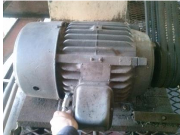
Figura 21. Ventilador inducido de horno punto 1H
