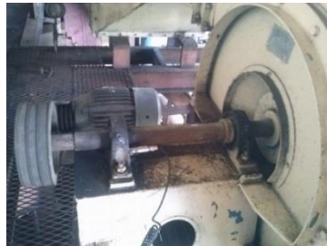
Figura 28. Ventilador inducido de horno punto 3ª
