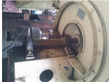
Figura 27. Ventilador inducido de horno punto 3V
