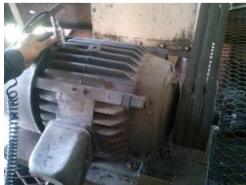
Figura 22. Ventilador inducido de horno punto 1V
