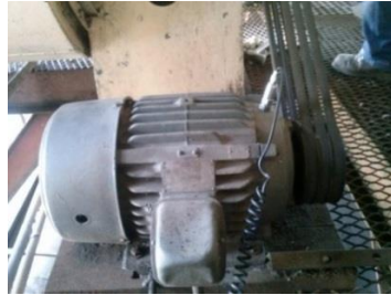
Figura 24. Ventilador inducido de horno punto 2V
