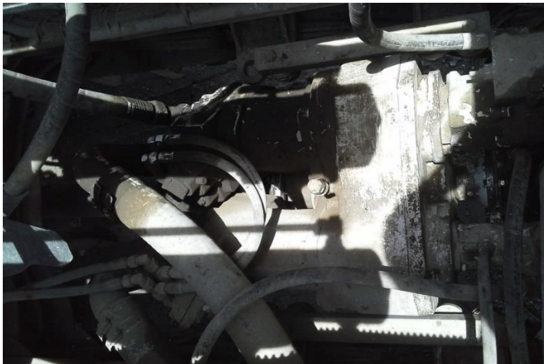
Figura 33. Mangueras de las bombas hidráulicas
