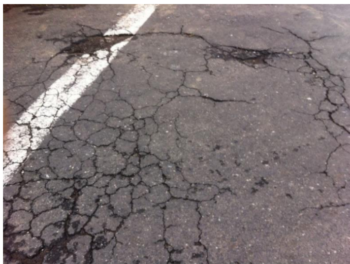
Figura 4. Deterioro visible provocado por la fatiga en el pavimento
