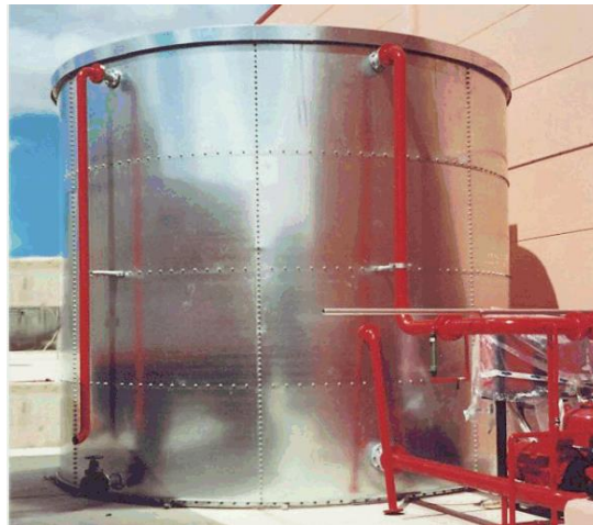
Figura 13. Tanques de abastecimiento de agua
