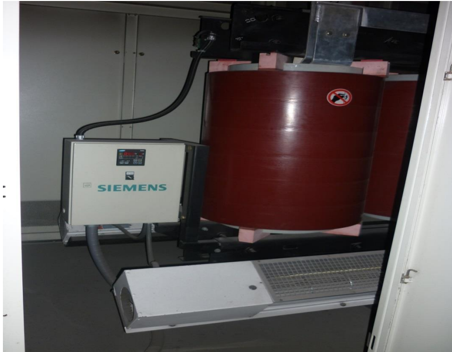
Figura 8. Banco de medición transformador principal
