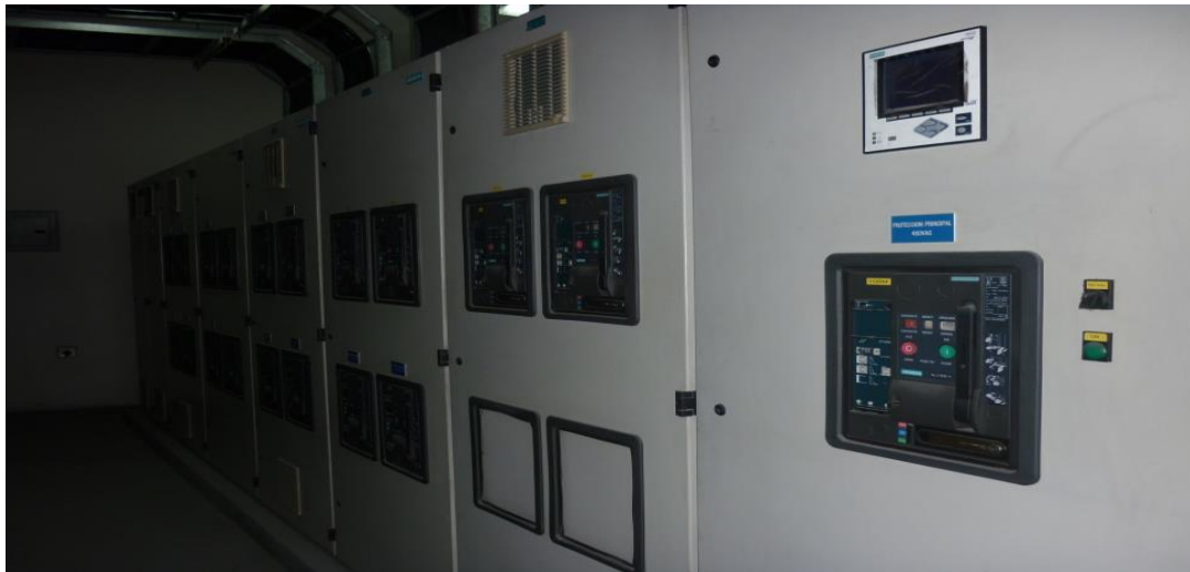
Figura 9. Paneles de distribución
