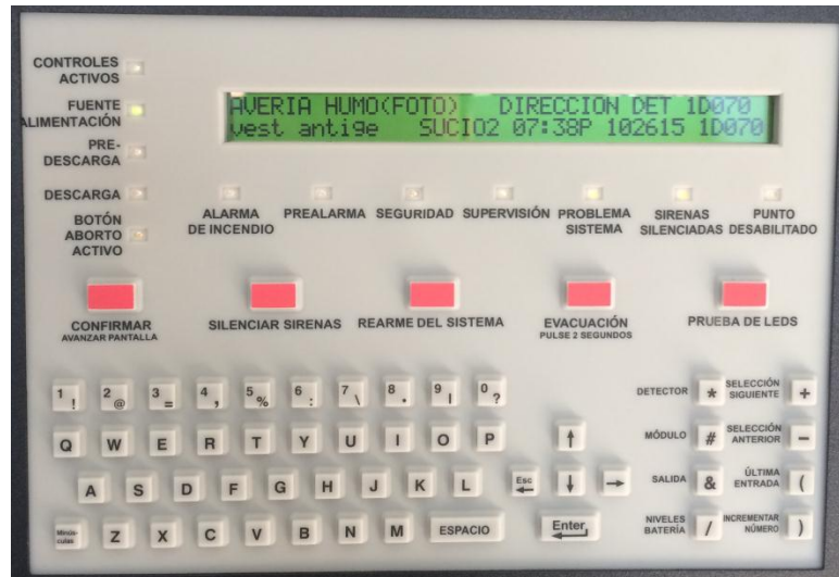
Figura 2. Foto real tablero alarma
