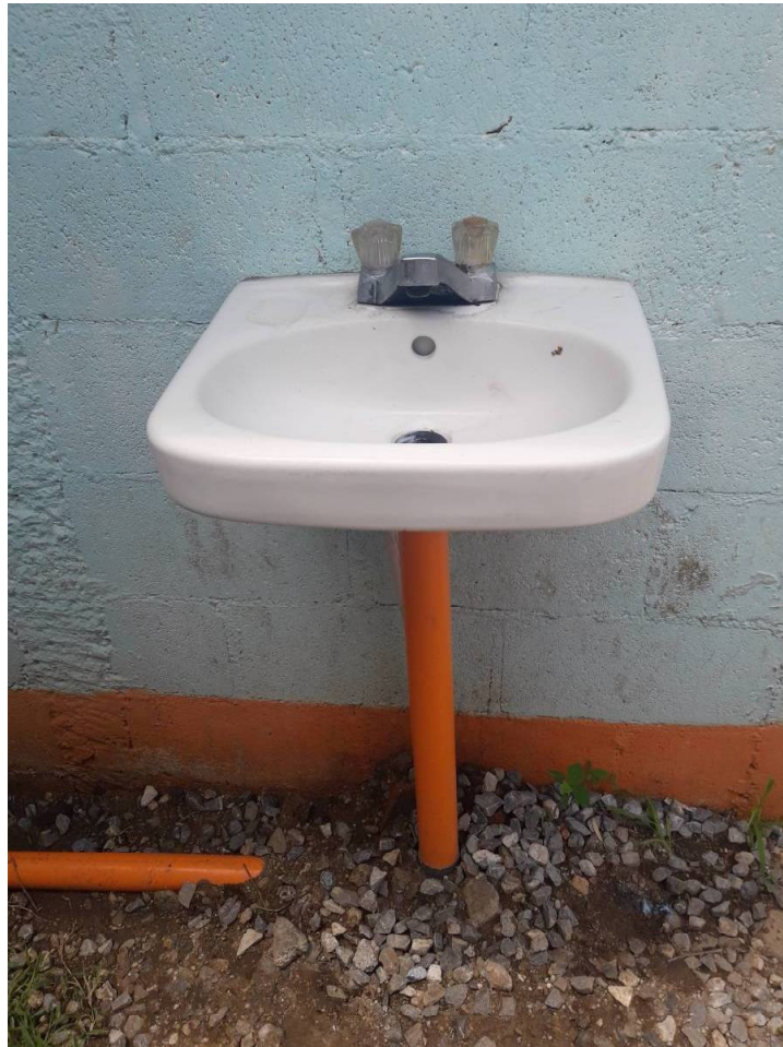
Lavamanos colocado en la EORM Casas de Pinto.
