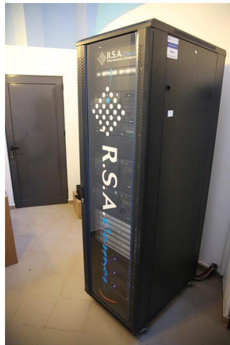
EL RACK A COLOCARSE EN LA SALA TÉCNICA
