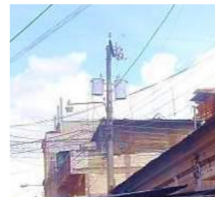
VISTA 3: POSTE CON TRANSFORMADOR ELÉCTRICO QUE SE ENCUENTRA A 50 MTS DEL TERRENO.
