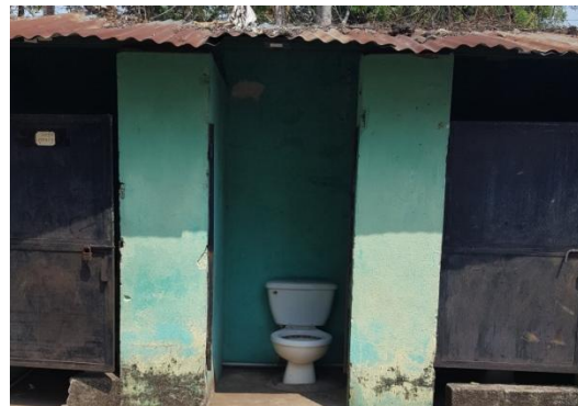
Fotografía No. 2 Estado de los baños, de láminas y puertas.
