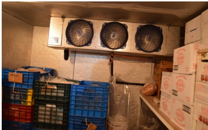
Figura 11. Condensador de cuarto frío
