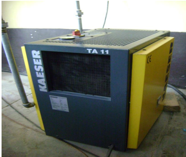
Figura 14. Secador refrigerativo utilizado en el sistema neumático
