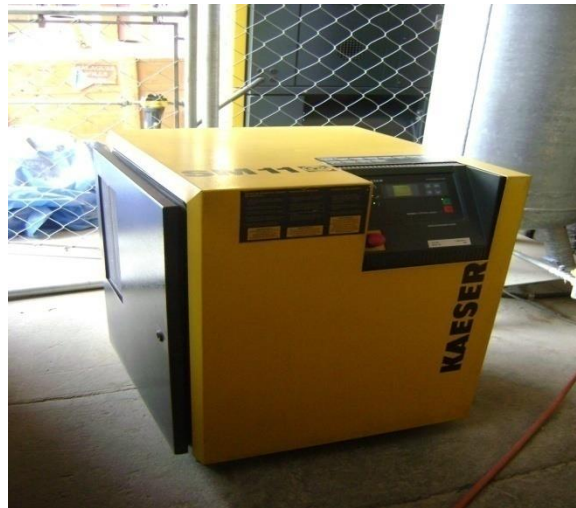
Figura 13. Compresor de tornillo utilizado en el sistema neumático
