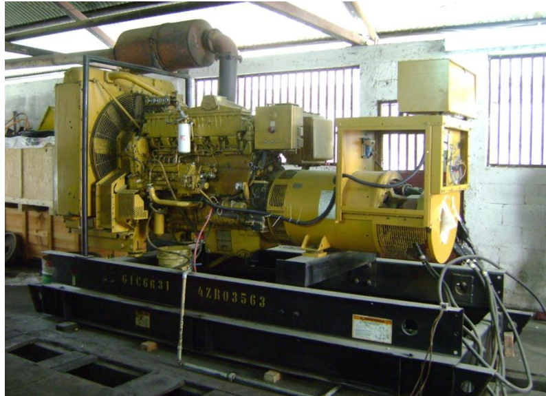
Figura 1. Grupo electrógeno para generación de energía eléctrica
