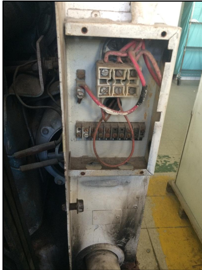
Figura 13. Fallas sistema eléctrico de secadoras
