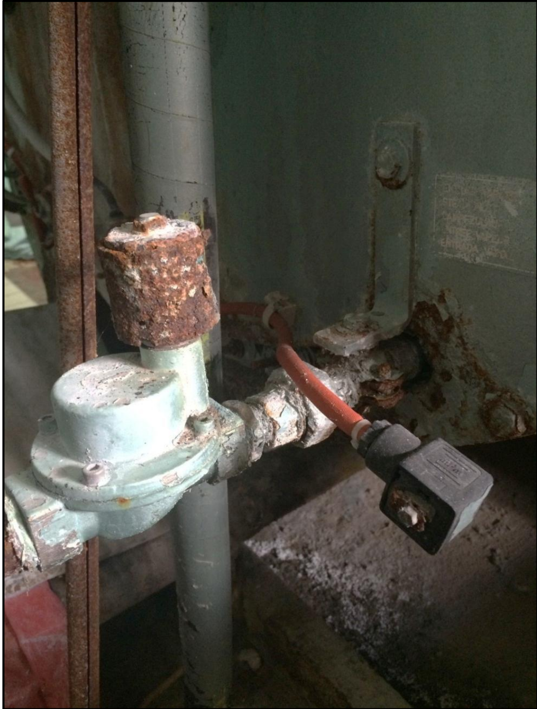
Figura 11. Oxidación de piezas eléctricas
