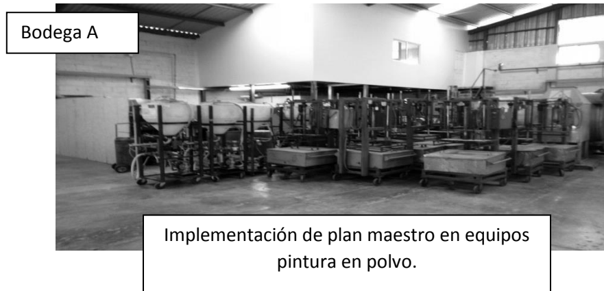
Figura 88. Área de pintura en polvo
