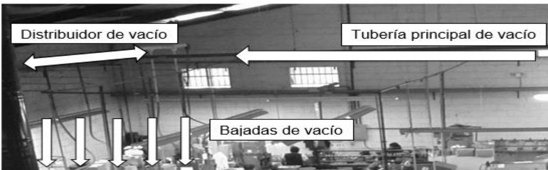
Figura 82. Sistema de tubería de vacío en área de decorado
