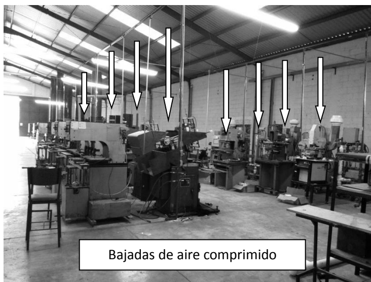
Figura 44. Instalación de aire comprimido en el área de decorado, tubería instalada desde la parte de arriba
