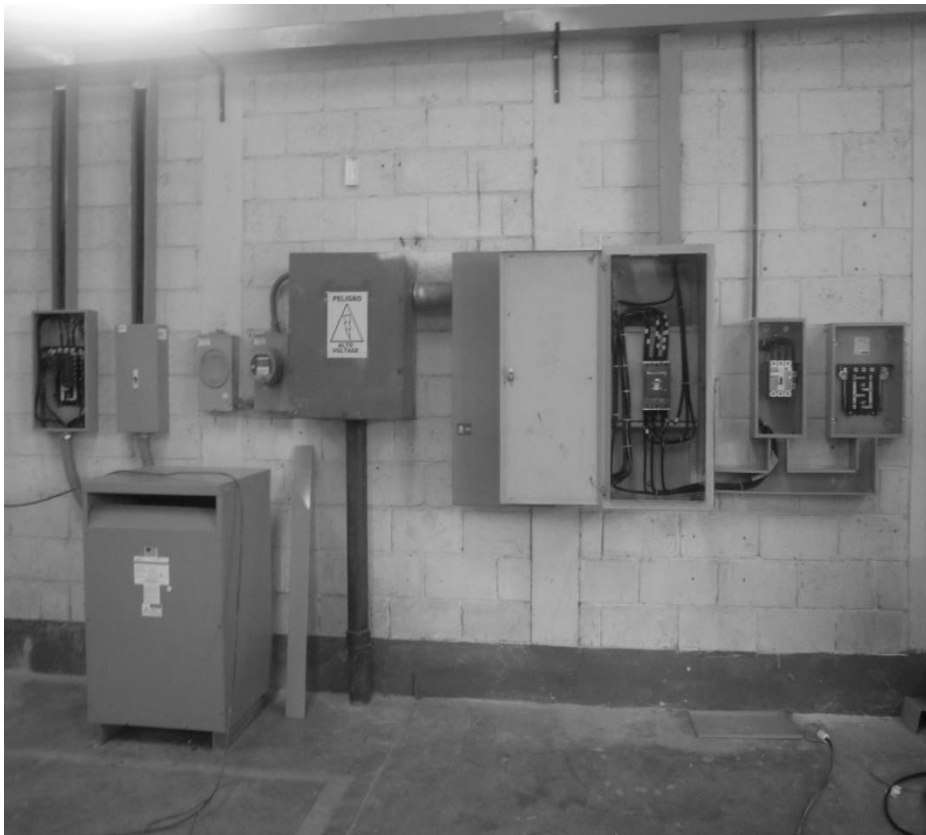
Figura 60. Subestación de planta de carnadas y anzuelos de pesca
