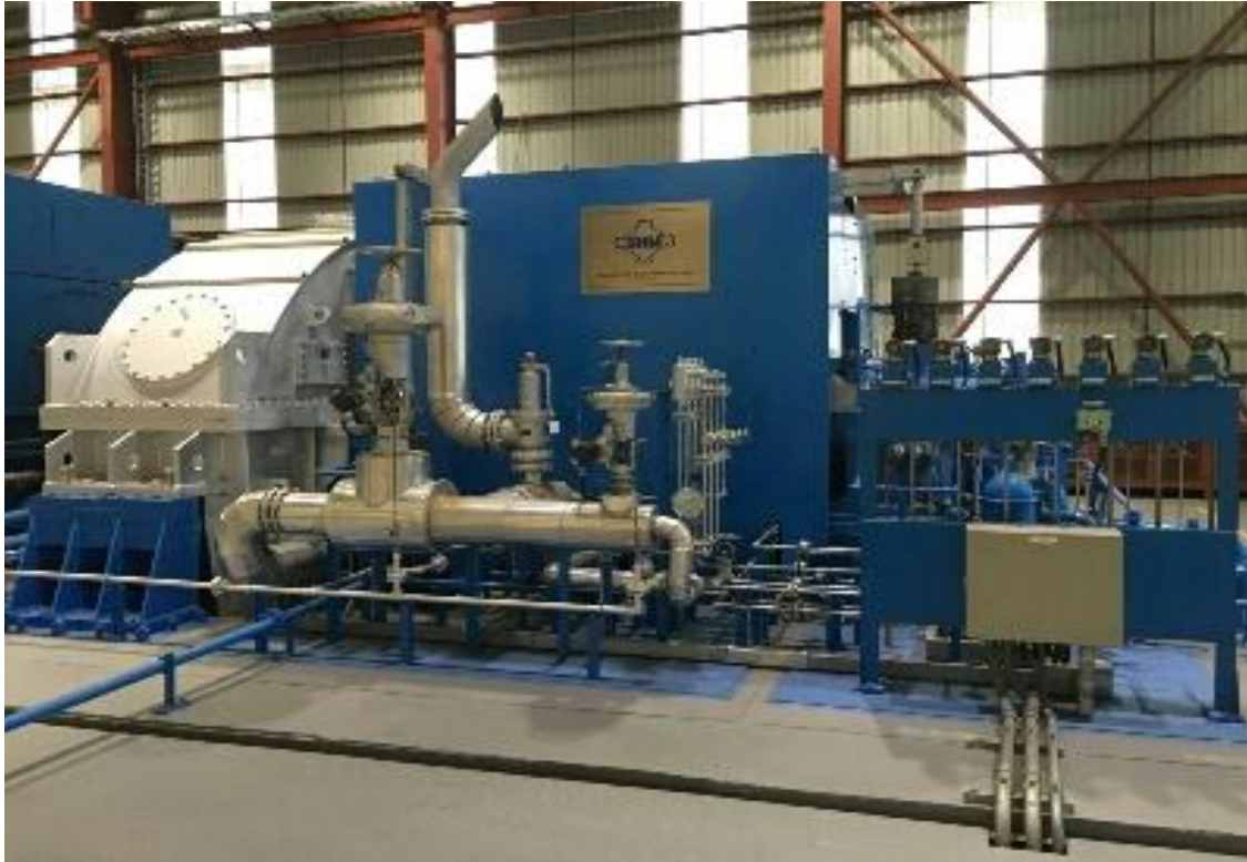
Figura 10. Turbina de vapor
