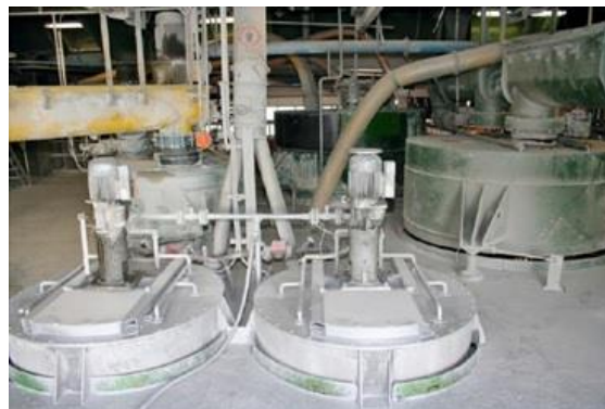
Figura 8. Almacenaje de espuma y mezcladora principal
