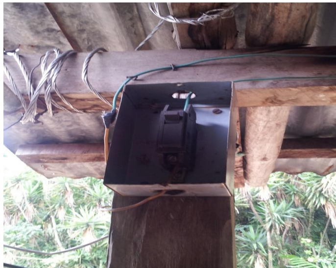
Figura 10. Tablero de protección principal (federal pacific electric)
