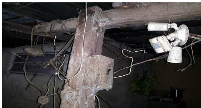
Figura 14. Instalaciones eléctricas en mal estado
