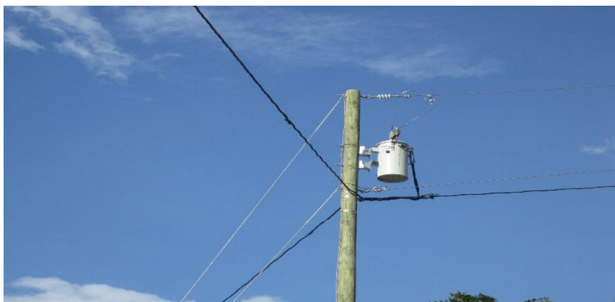
Figura 22. Red de baja tensión con triplex trenzado # 2
