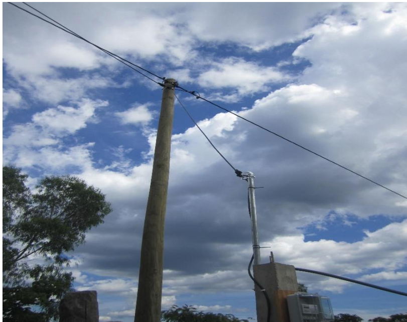
Figura 25. Acometida instalada con cable concéntrico
