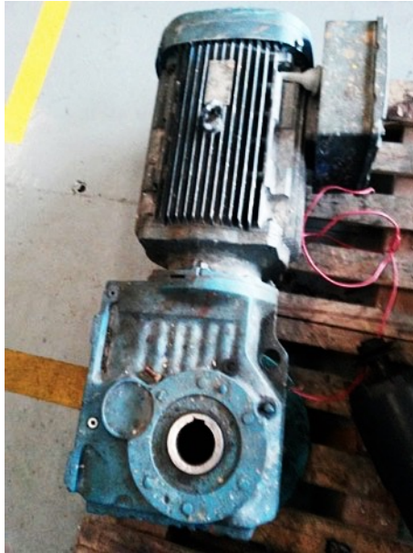
Figura 15. Motorreductor del tanque núm. 16 de látex AV
