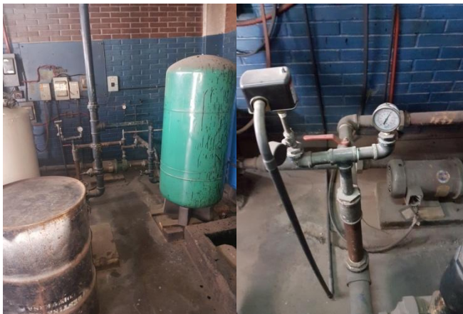
Figura 52. Sistema de tubería de toda clase área de calderas
