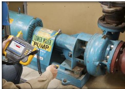
Figura 66. Bomba centrífuga análisis de vibración
