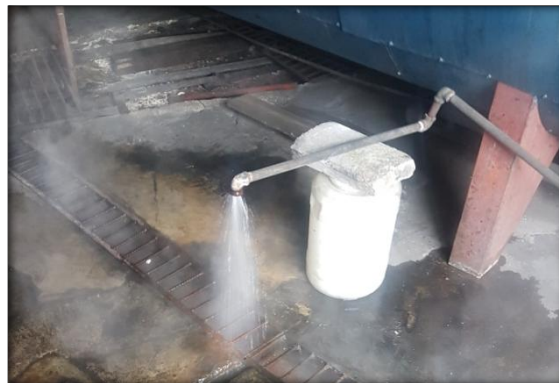
Figura 59. Fuga de condensado, Incán
