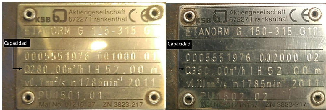
Figura 79. Placa de información de bombas actualmente en operación
