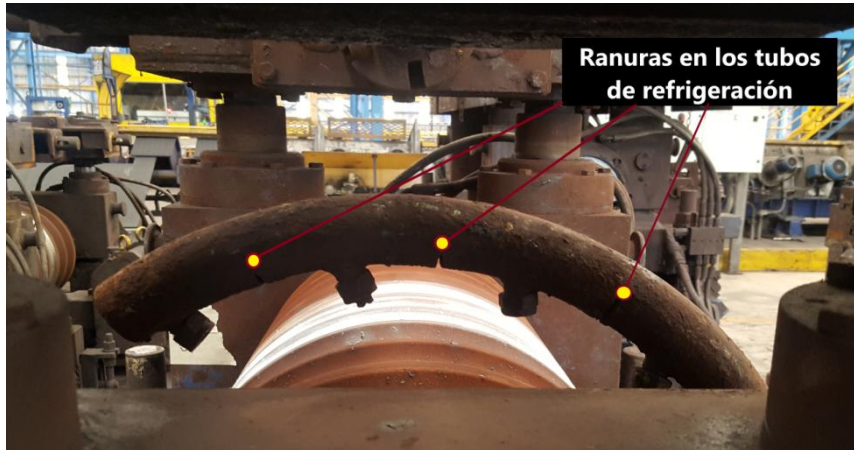
Figura 28. Ranuras en los tubos de descarga
