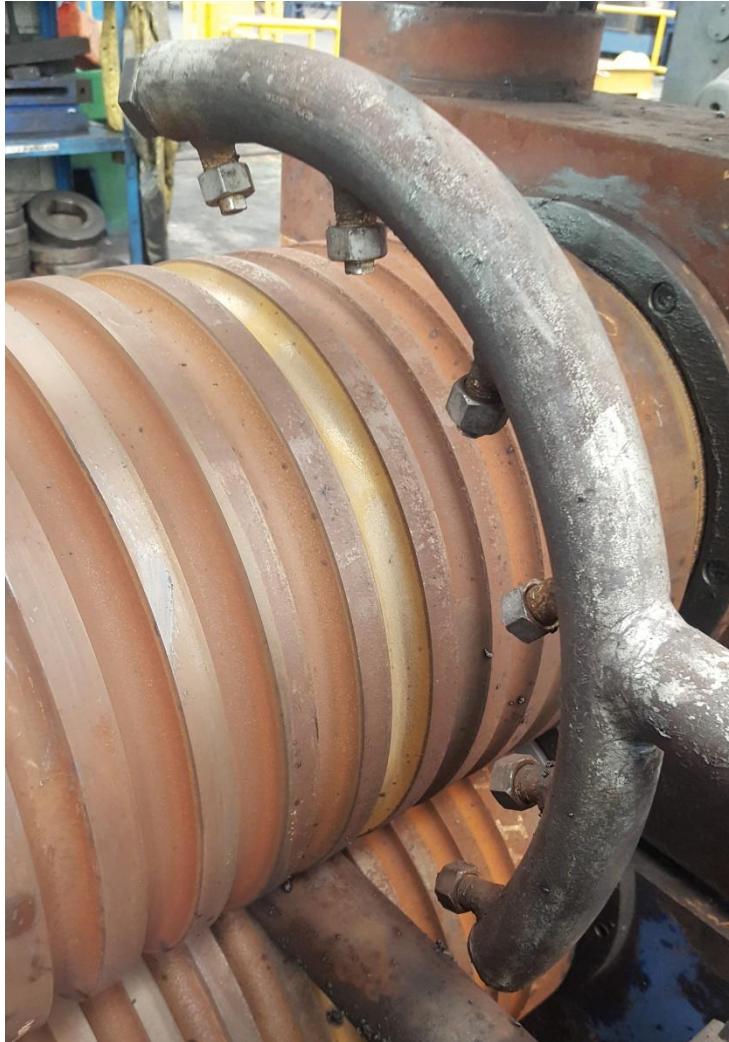
Figura 22. Tubería de refrigeración de acero negro
