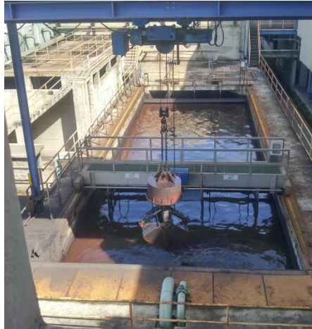
Figura 84. Grúa que limpia la fosa de cascarilla
