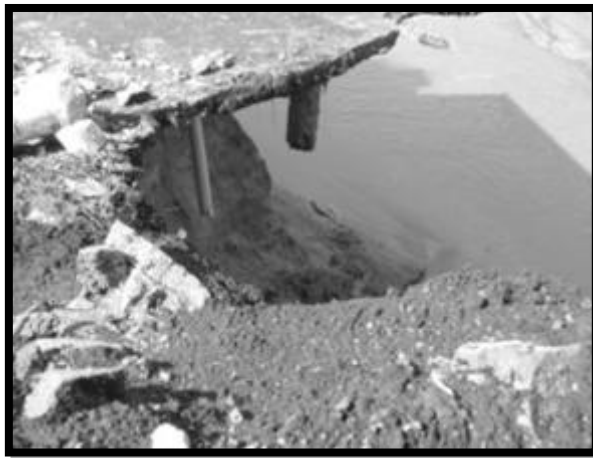
Figura 8. daños a la es la estructura del canal lateral, sec. 2
