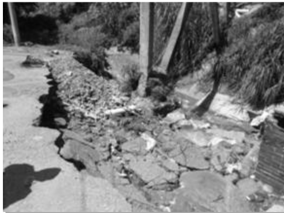
Figura 9. Daños a la estructura asfalto, sector 6
