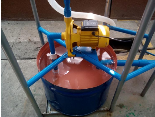
Figura 20. Equipo de bombeo y depósito de agua
