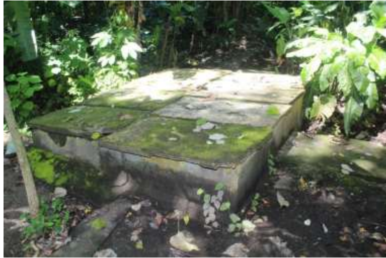
Figura 7. Caja de captación del río Agua Zarca
