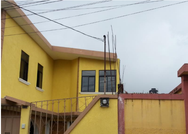
Figura 16. Acometida eléctrica con empotramientos
