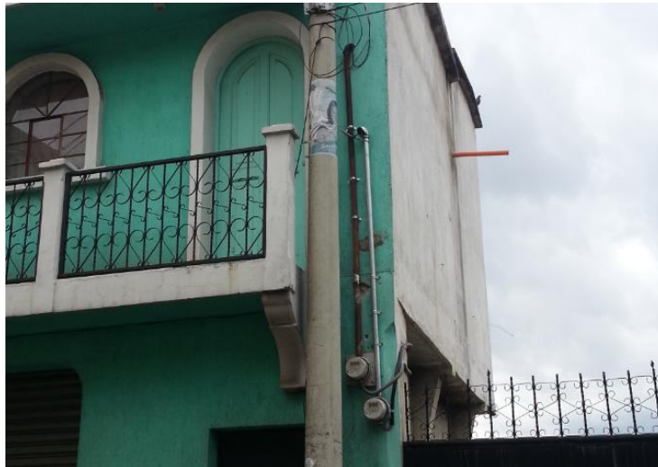
Figura 17. Acometida eléctrica acometida sobre fachada
