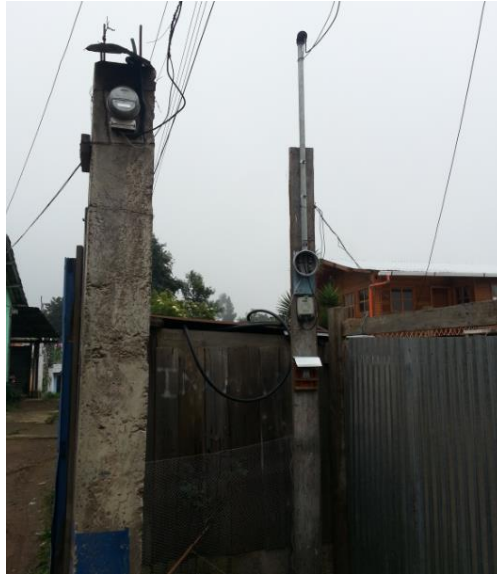
Figura 18. Acometida eléctrica en columna
