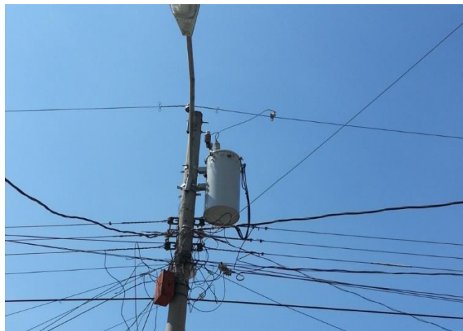
Figura 23. Centro de transformación de acometida en media tensión 13,8 kV
