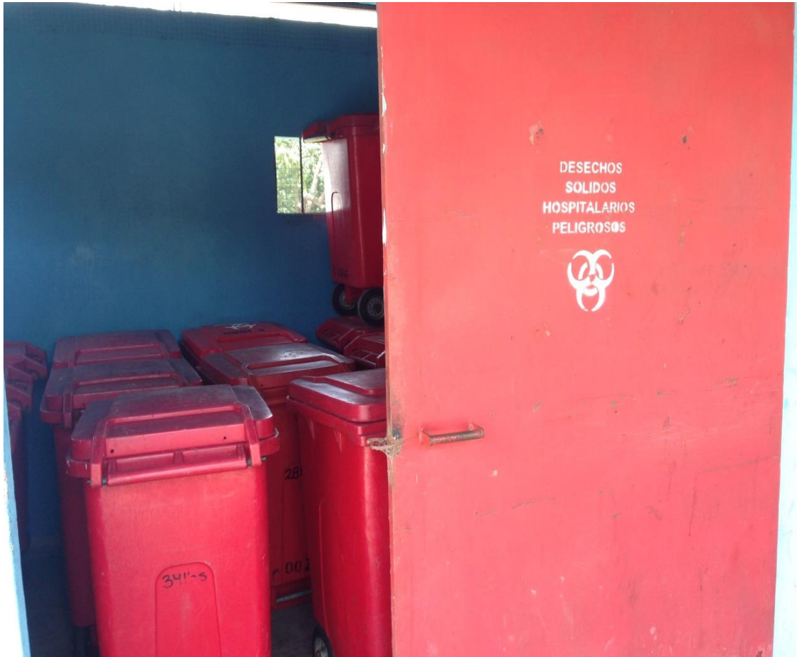
Figura 12. Instalaciones para almacenamiento temporal de desechos sólidos hospitalarios peligrosos
